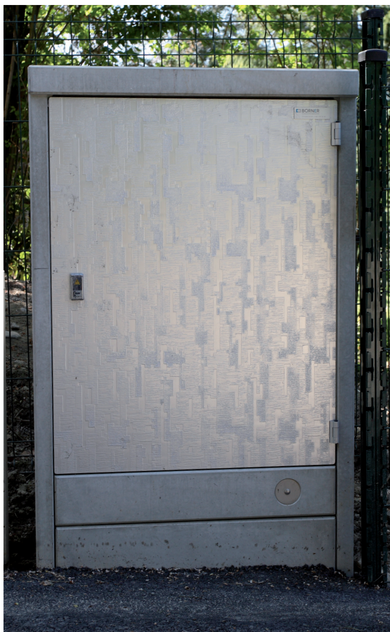
Coffret de distribution électricité en élévation
